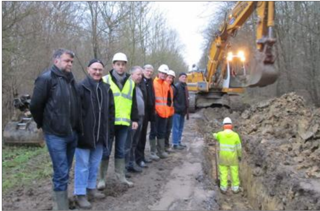
Le nouveau réseau d'assainissement et de refoulement sera en service dès février. Photo RL
